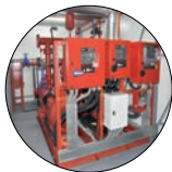
Equipo Contra Incendios
