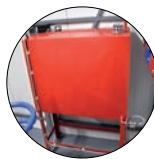
Detalle del depósito.
