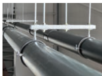
Soportaciones metálicas totalmente re-diseñadas.
